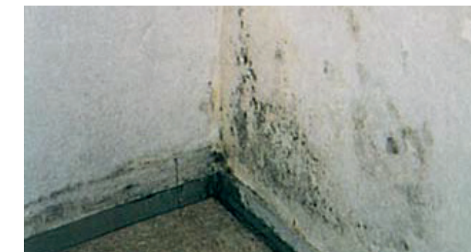
Przykład degradacji ściany
